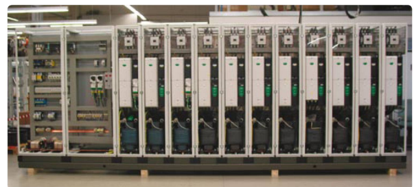
Tavle fra PV-anlæg, bl.a. med 9 stk. Unidrive SP
